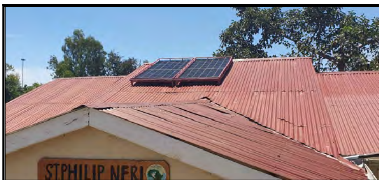
Solárne panely na streche,,,,,slnka v Kisumu máme dost'.
